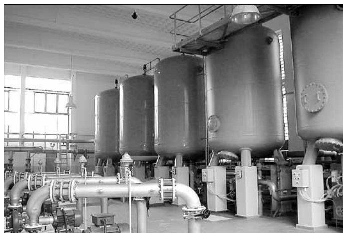
Blick in die Filterhalle im Wasserwerk Vetschau.
